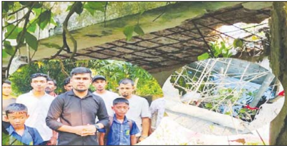
কচুয়ার মনোহরপুর গ্রামের ভেঙ্গে যাওয়া কালভার্ট ব্রিজের চিত্র।
